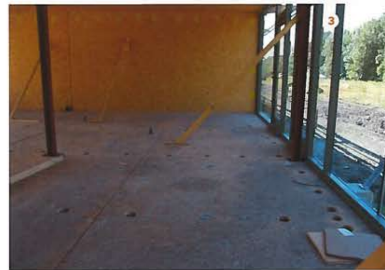
1 // De vloerdozen liggen op een raster van betonbalken, dat aan de voor- en achterzijde in principe open is. Waar een windverband is aangebracht in de achtergevel, is een extra betonbalk toegepast in de lengterichting. 2 // De woningen worden door de bewoners zelf afgebouwd, inclusief installaties. 3 // In dak, wanden en vloeren zijn gaten geboord om de dooselementen af te vullen met cellulose-isolatie.
