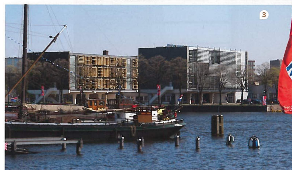
1 // De nieuwe ruimtes zijn flexibel indeelbaar. 2 // Het pand in vroeger jaren. De trappenhuizen waren ook toen al herkenbaar aan de gebouwhoge glaspartijen. 3 // Gebouw 27 vormde een duo met het naastgelegen pand, dat al eerder werd gerenoveerd.
